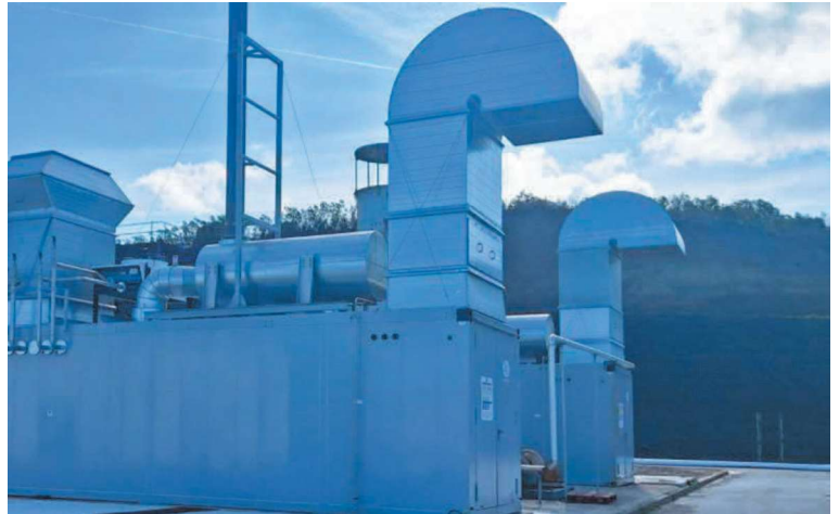
Imagem: Sistema de Tratamento e Valorização do Biogás captado do Aterro Sanitário.
