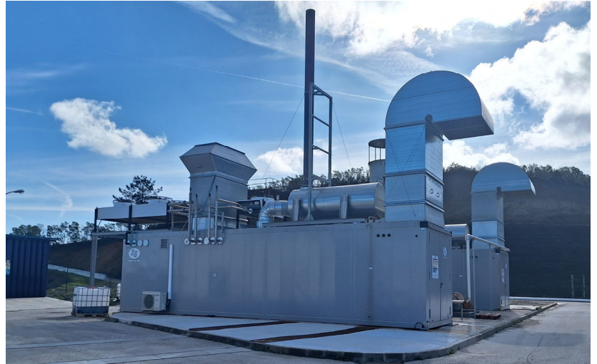
Imagem: Sistema de Tratamento e Valorização do Biogás do Aterro Sanitário do Sotavento.
