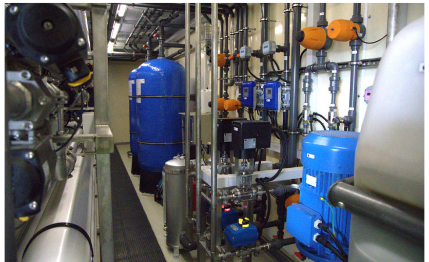
Imagem: Equipamento da Unidade de Osmose Inversa
